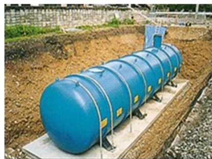
【耐震性貯水槽】
